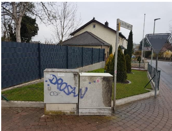
Abbildung 1: Verteilerkasten des EWR im April 2021
