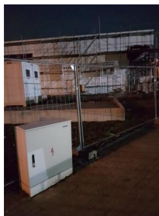
Abbildung 1: Stromverteilerkasten ggü. Landhandel. Aufnahmedatum: 22.02.2021
